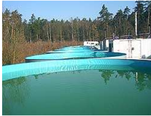
Abbildung 6: Rückhaltebecken für das Geothermieprojekt Groß Schönebeck. Quelle: www.bgr.bund.de .
