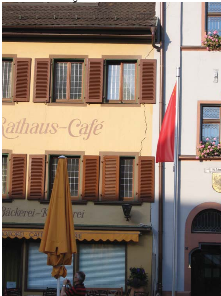
Abb. 2: Risse in einem Haus in der Altstadt von Staufen BW. Die Risse werden durch Bodenhebungen verursacht, die unmittelbar im Zusammenhang mit Geothermie Bohrungen stehen.
