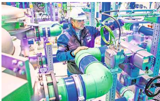
Im April wurde in Schwerin die Geothermieanlage der Stadtwerke in Betrieb genommen.
