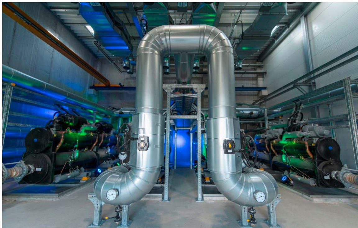
◀ Fig. 1 : Les pompes à chaleur haute performance constituent le cœur de la centrale de chauffage géothermique et rendent l'installation unique en Allemagne jusqu'à ce jour.
