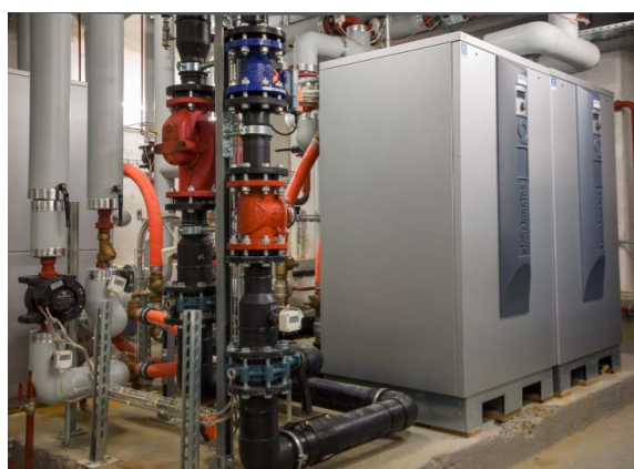
▲ Fig. 3: Les pompes à chaleur responsables de la production de chaleur et l'eau chaude sanitaire.
