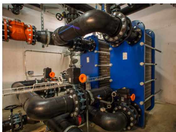
▲ Fig. 2: Les échangeurs de chaleur alimentés par la nappe phréatique distribue l'énergie dans le réseau froid vers les pompes à chaleur décentralisées.
