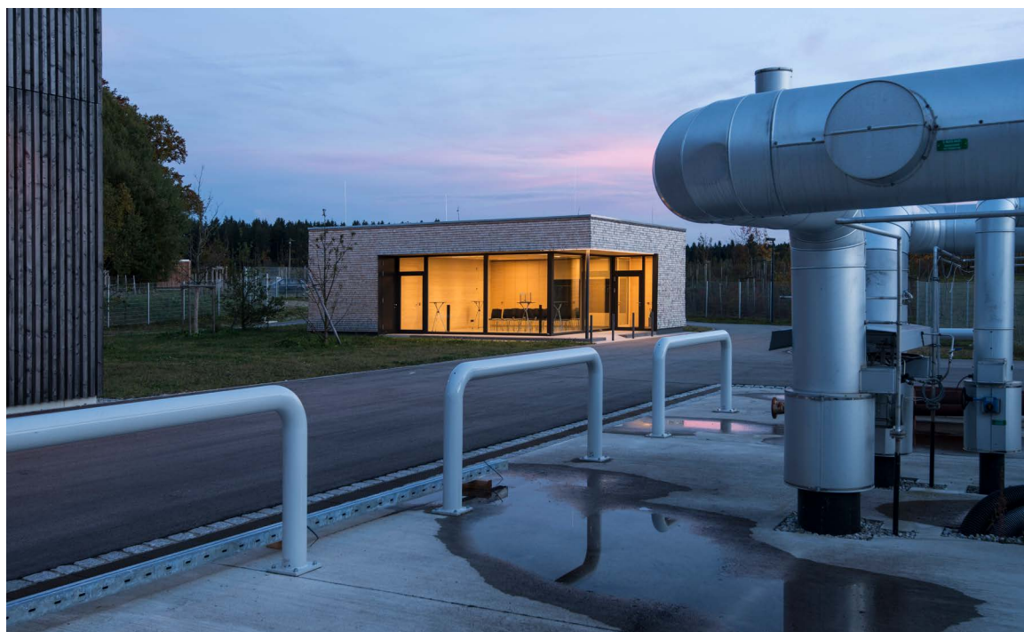
◀ Fig. 1: Installation géothermique de Laufzorn
