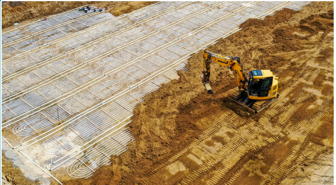
► Abb. 1: Im Soester Norden entsteht derzeit das größte Neubaugebiet der Stadt mit insgesamt 31.700 m 2 Kollektorfläche.
